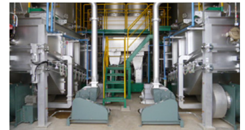
ニプロファーマ大館工場 バイオマスボイラー
