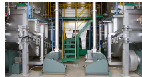
大館工場のバイオマスボイラー
